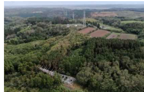
台風15号により倒壊した鉄塔
