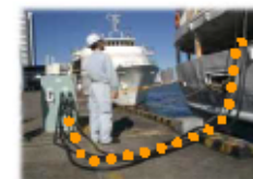
電力供給設備
