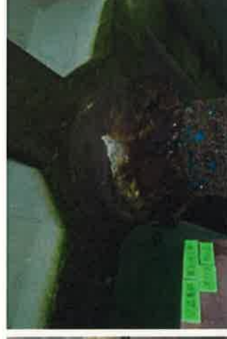
岸壁の老朽化 (栈橋式岸壁鋼管腐食)
